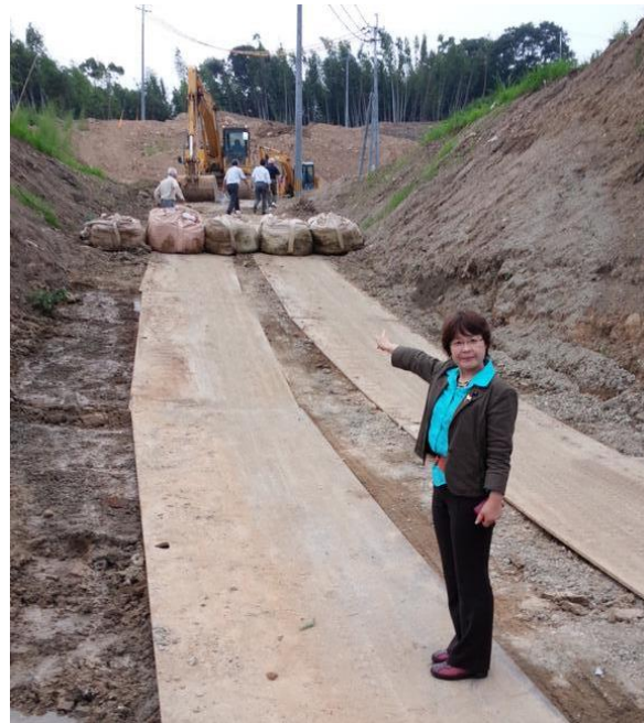
調整池が間に合わず大量の土砂が流れる開発現場(飯塚)
